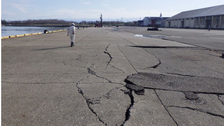
①被災状況(1/2(火)撮影)
