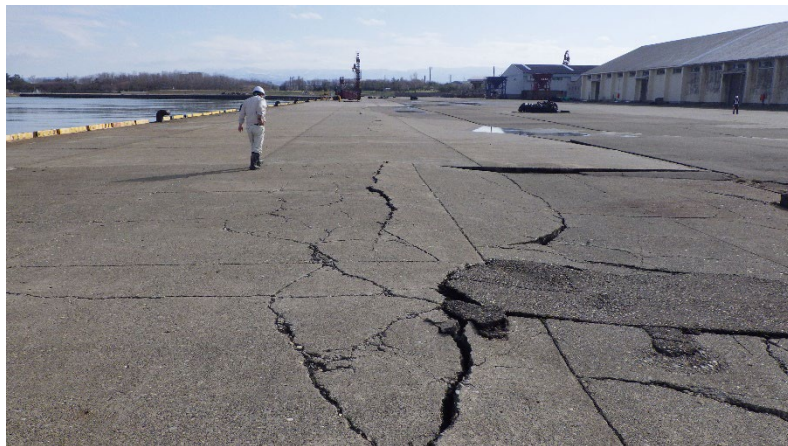
①被災状況(R6.1/2(火)撮影)
